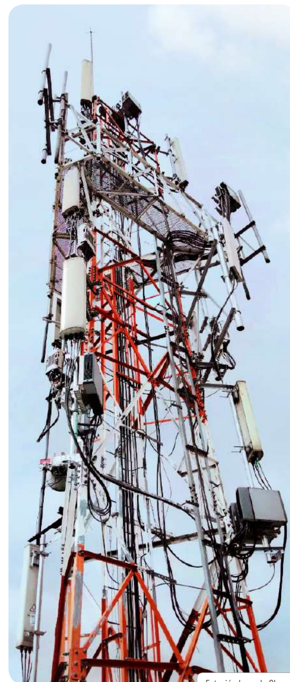
Estación base de Claro.
